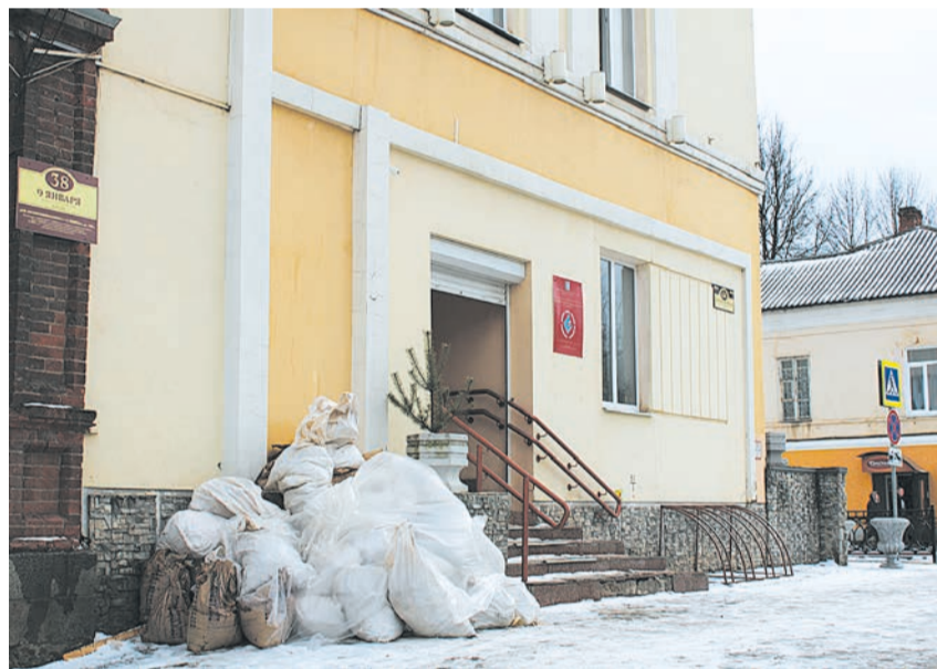
Пока коллективу ДШИ приходится терпеть неудобства, зато следующий учебный год начнётся в полностью обновлённом здании
